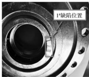
图4 1#缺陷位置 Fig. 4 1# Defect location
